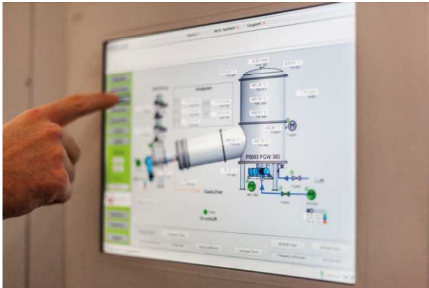
Kontrollbildschirm des Holzvergasers Foto: Stadtwerke Rosenheim
