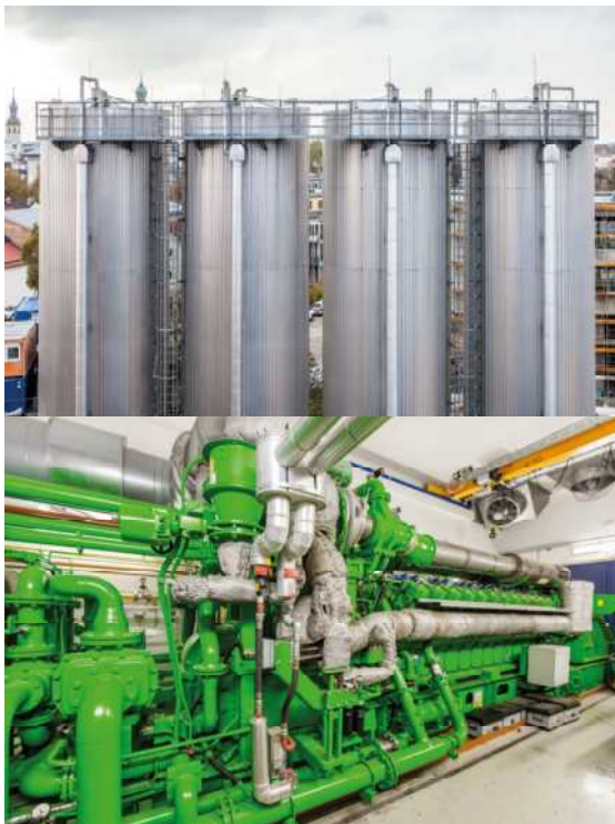
Wärmespeicher (oben), Gasmotor (unten) Fotos: Stadtwerke Rosenheim
